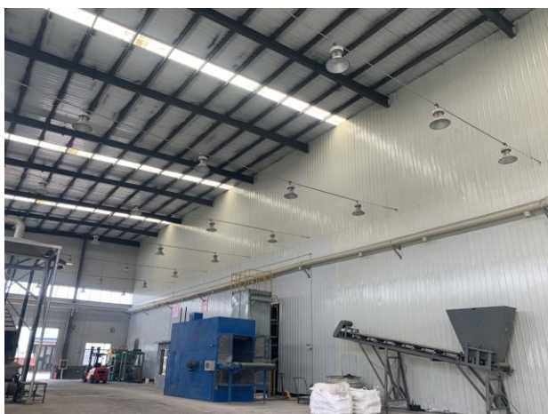
养护区废气收集管道
