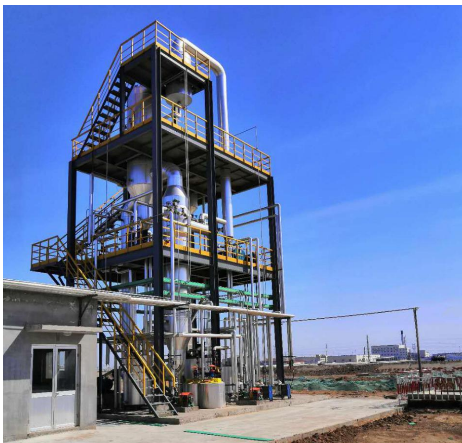
已建成的配套渗滤液处理装置
