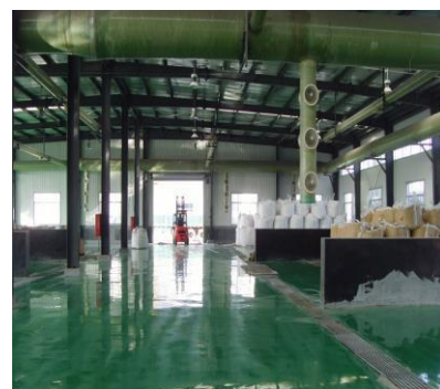
危废暂存库废气收集管网
