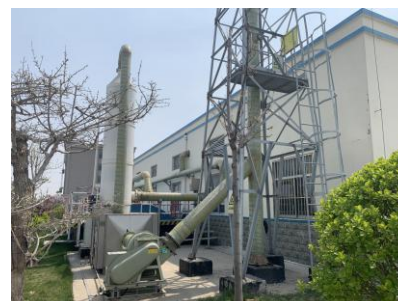
渗滤液处理站废气排气筒
