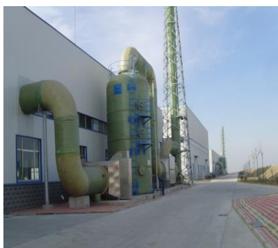
危废暂存仓库一 废气处理设施及排气筒
