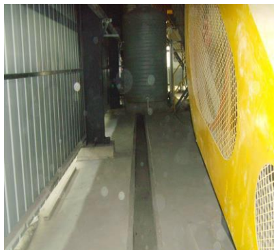
固化车间导排沟
