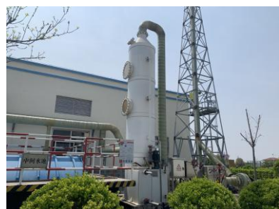
渗滤液处理站废气处理设施
