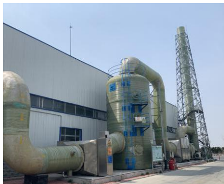
危废暂存仓库二 废气处理设施及排气筒
