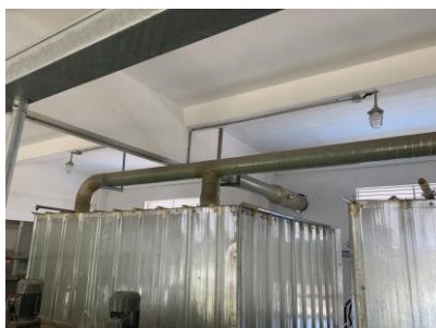
渗滤液处理站废气收集管网
