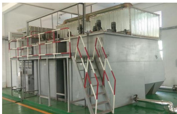
渗滤液处理设施
