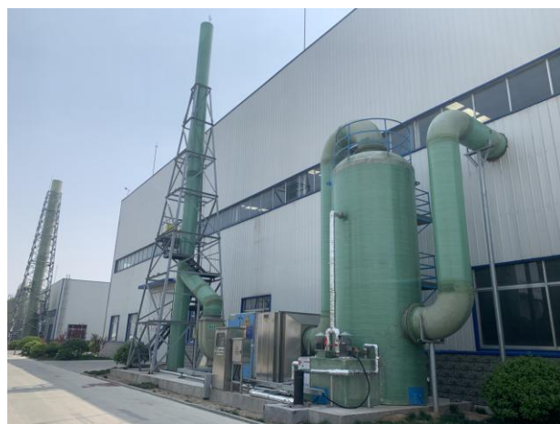
养护区废气处理设施及排气筒
