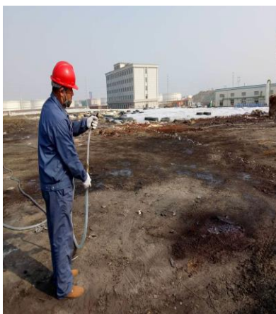
填埋场洒水抑尘
