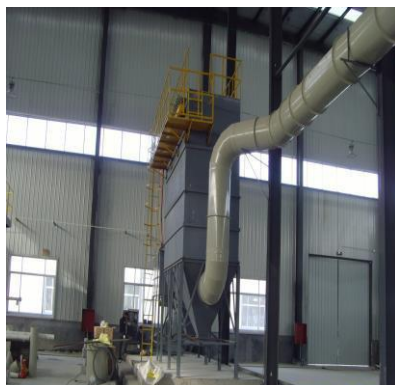
固化废气处理设施
