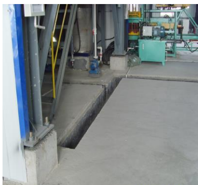
固化车间导排沟
